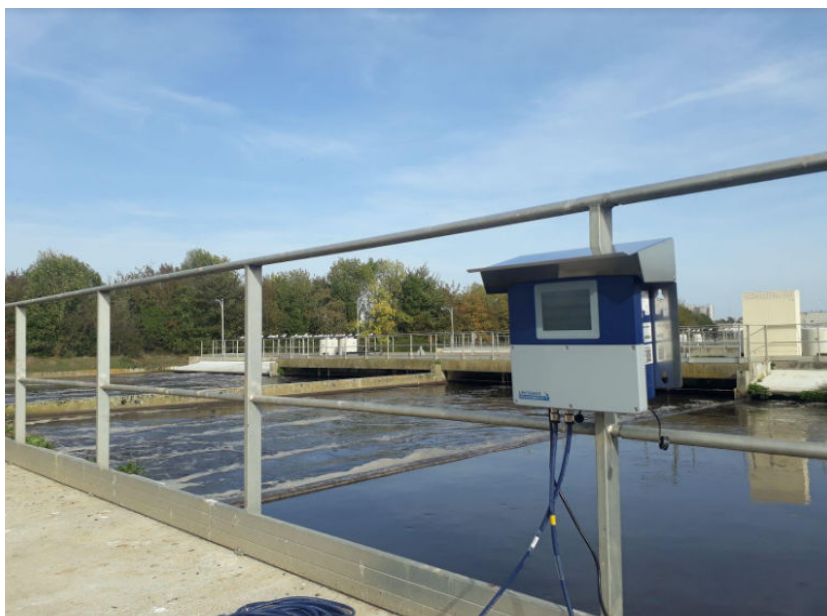
Installation N2O sur la station d'épuration de Beaurade, Rennes Métropole
